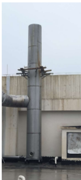
发酵废气排气筒
